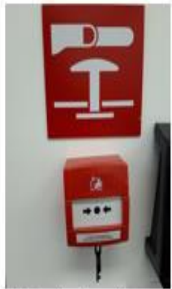
Pulsante allarme incendio
