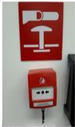
Pulsante allarme incendio
